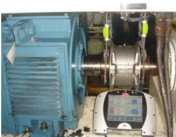
De vetgesmeerde koppeling en de gelijkstroommotor van 400 KW.
