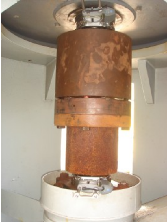
De koppeling die de elektromotor verbind met de pomp van 7 meter lang. Boven en onder zijn de laserkoppen van de uitlijnset te zien.
